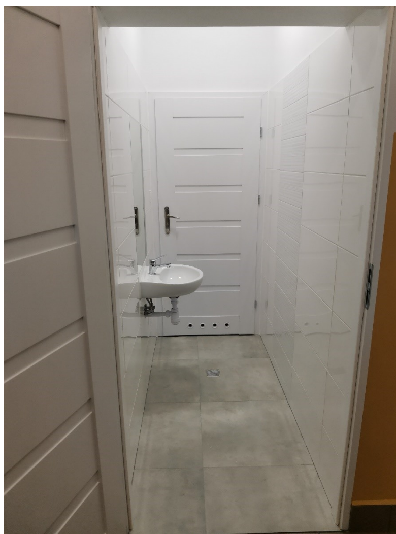
Fot. Wykonane zadanie pn.: „Przebudowa i dostosowanie drzwi wejściowych oraz pomieszczeń higieniczno-sanitarnych dla potrzeb osób niepełnosprawnych w Szkole Podstawowej w Kopciach”
